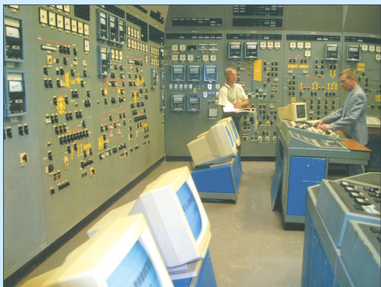
Полномасштабный тренажер блочного щита управления АЭС в межфакультетском учебном центре
